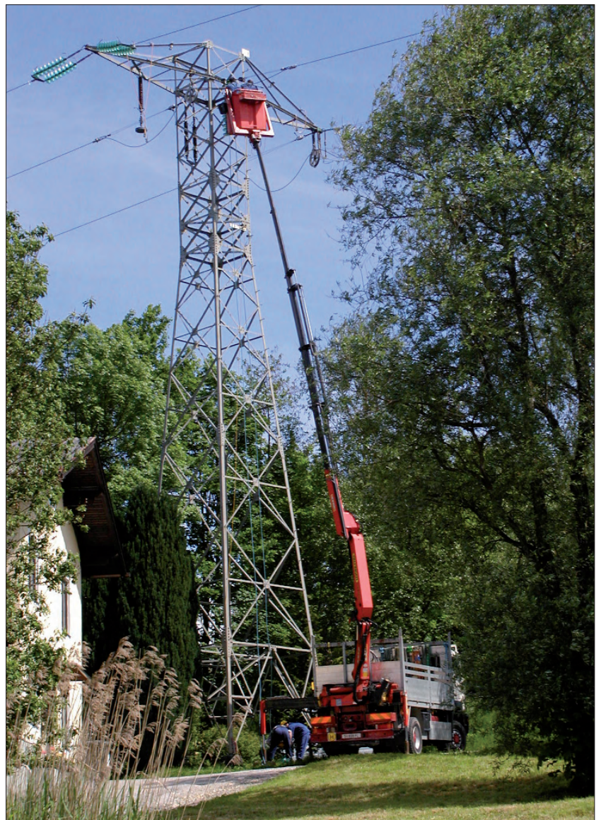
Bild 1. Mit der Argos-Lösung für mobiles Workforce-Management lassen sich neben Arbeiten in Netzbau und Netzbetrieb auch Aufgaben zu Zählermanagement und Ablesung steuern
