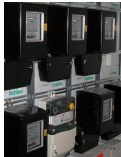
Abb.2: Heute noch in der Unterzahl: Das Verhältnis zwischen eingebauten Ferraris-Zählern und Smart Meter wird sich in den nächsten Jahren umkehren.
